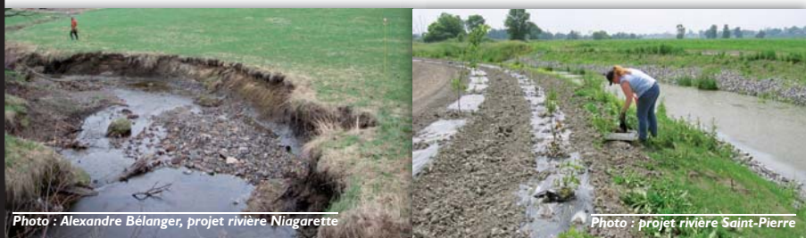
Photo : Alexandre Bélanger, projet rivière Niagarettte Berge érodée par la vitesse d'écoulement de l'eau
