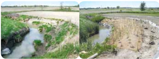
À GAUCHE - Problèmes d'érosion Projet ruisseau Richer À DROITE - Travaux de reprofilage et stabilisation Projet ruisseau Richer
